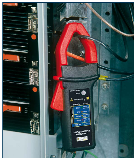
Einfache Erfassung des Stroms an einer Schalttafel
