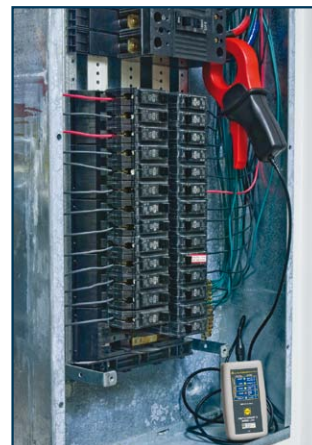
Erfassung des Stroms an einer Verzweigung mit dem L101
